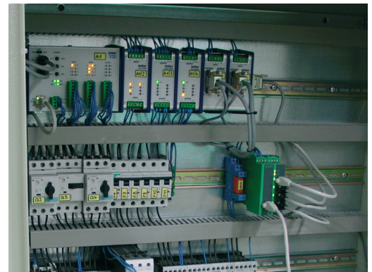
Numera en vanlig bild - Ethernet baserad styrteknik i kopplingsskåp. En tidig start i denna nätverksteknik belönas med marknadsförsprång.
